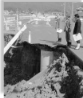
園部町内の道路陥没 (10月24日)
