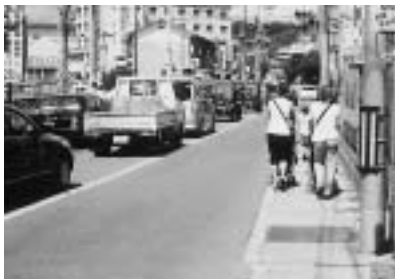
これでも歩道？溝ブタの上を歩く (府道京都宇治線六地藏町並交差点南)
