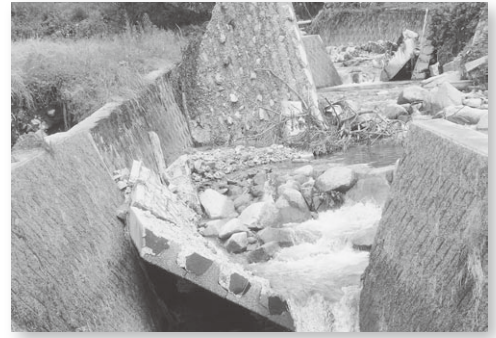
9月14日、台風9号による豪雨被害調査 (福知山市夜久野町)
