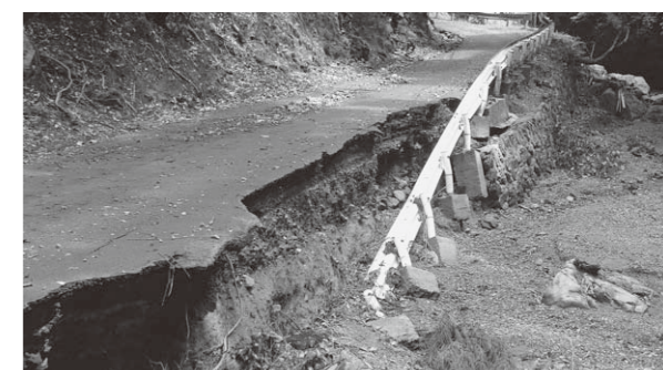
8月16日、崩落した道路（宇治市志津川）
