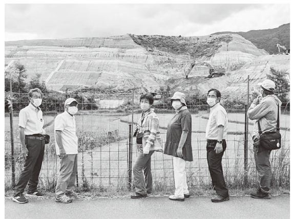
南山城村メガソーラー建設地の 土石流調査(8月10日)
