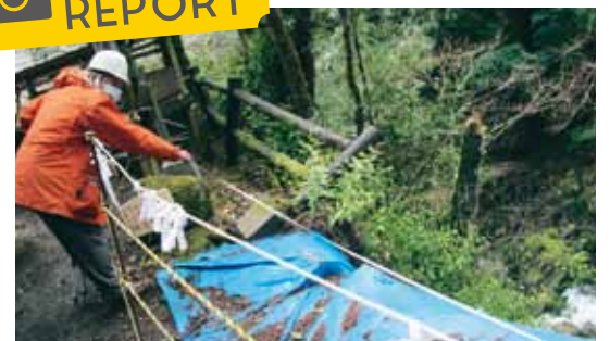
福知山市・天岩戸神社のかけ崩れ現場を調査(2月23日)。復旧工事の遅れを質しました。
